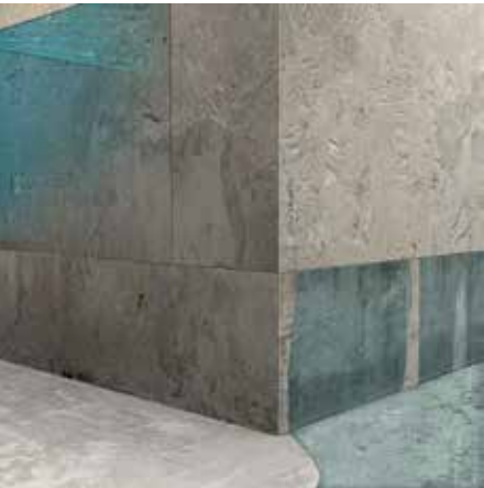
Проникновение воды через рабочий шов бетонирования
